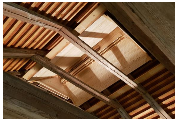
Die Wärmeglocke im Dachstuhl der Böhmfelder Kirche mit einer Seitenlänge von 3mx1,50m. Foto: Peter Wankerl
